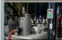
UNIDAD DESCARGA BIOCOMBUSTIBLES
